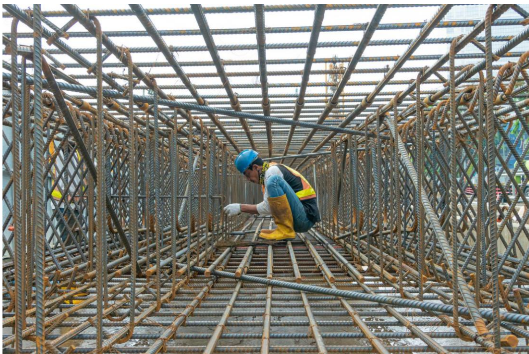
Pekerja konstruksi CP202 sedang menyiapkan pembesian struktur D-Wall. Foto oleh PT MRT Jakarta (Perseroda)
